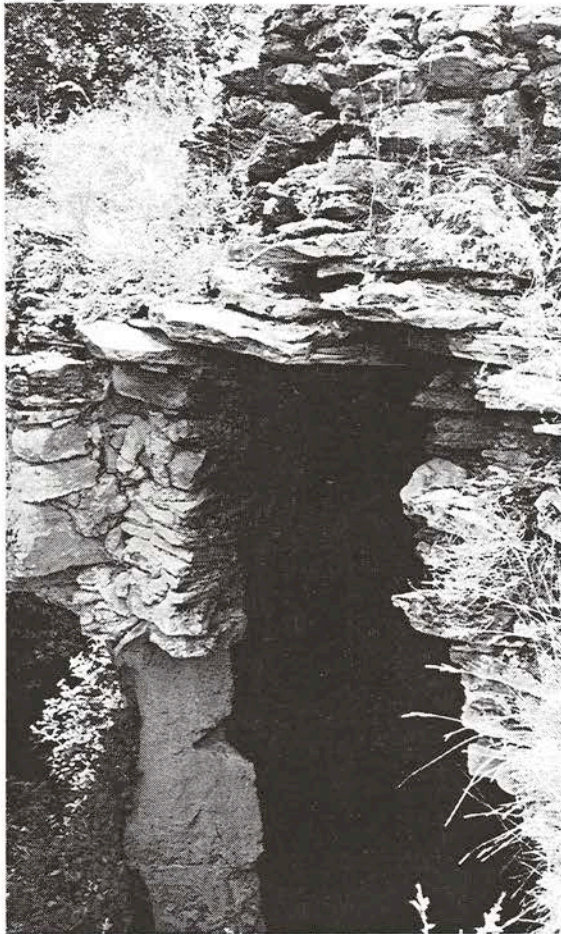
Parte trasera del pozo de la nieve en estado de ruina
